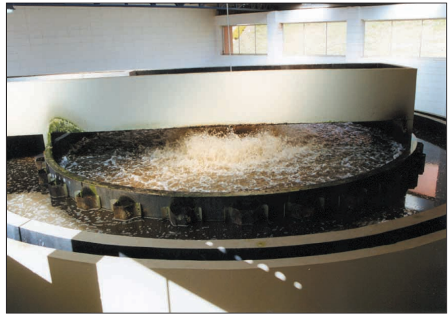
Estação de Tratamento de Efluentes
