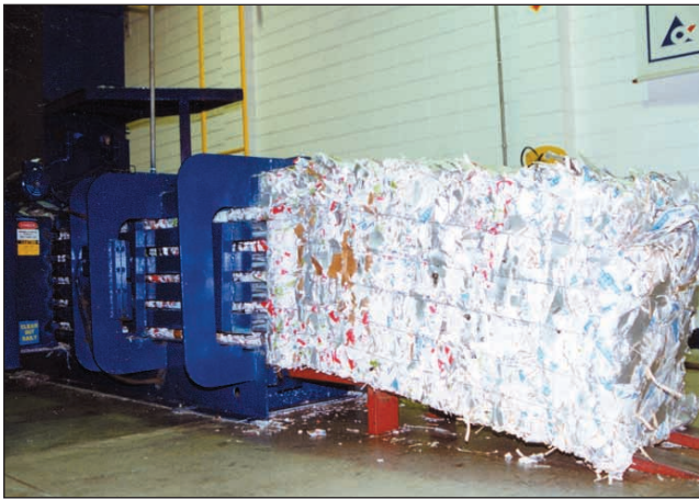
Planta de Resíduos Sólidos
