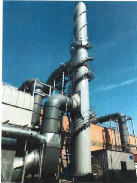
DA019 生产废气排放口
