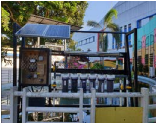
Filtrasi Air Wudhu
